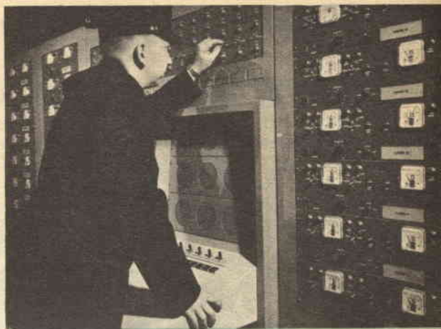
Impianti centralizzati di controllo in molti grandi stabilimenti; permettono a una sola guardia di sorvegliare luoghi distanti. I segnali provenienti da ogni tipo di rivelatore possono essere collegati ad un solo pannello.
