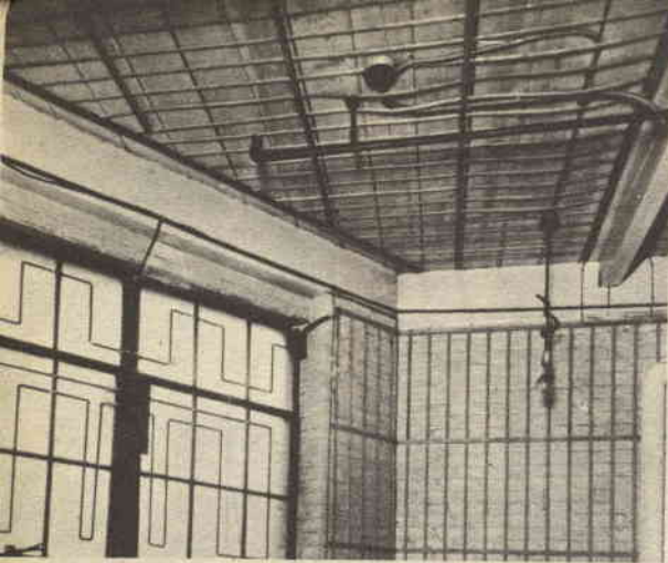
Circuiti di stagnola circondano i muri, le porte, le finestre, i pavimenti e i soffitti di un fabbricato. Vengono usati a complemento di allarmi per porte e finestra.
